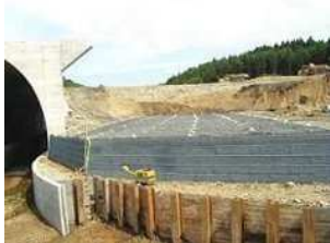
パラリンク敷網+ ジオテキスタイル補強土壁 JH 日本海沿岸東北自動車道 名ヶ沢北工事 2
