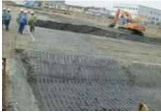
東京電力富津火力工事 産廃処理設備
